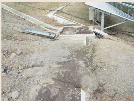
排水計画の瑕疵により開水路に堆積した土砂
