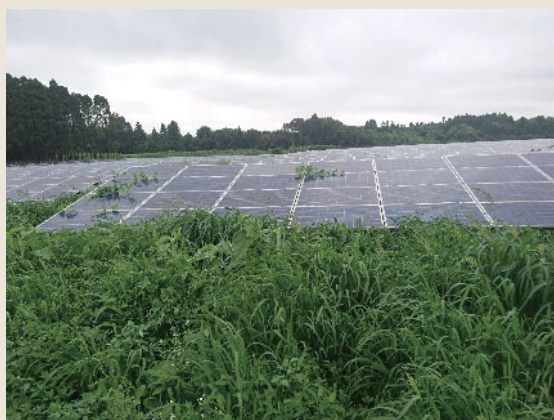
雑草の繁茂した発電所
