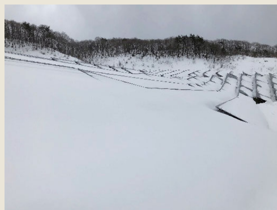
発電所の積雪状況
