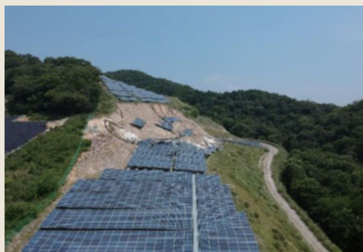
台風被害による大規模崩落事例（出典：資源エネルギー庁資料）
